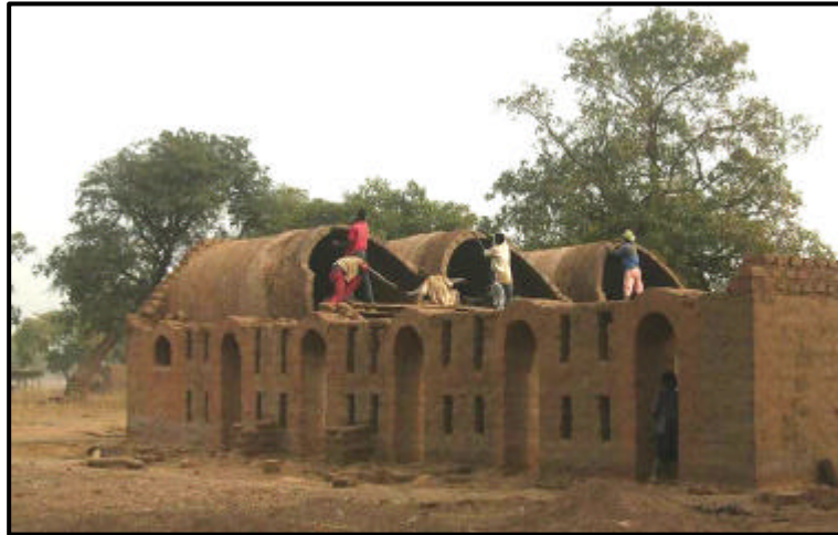
Figure 28 : Petit Balé, Avancement simultané des 3 VN de l'église catholique ; Photo : Wyss 2005
