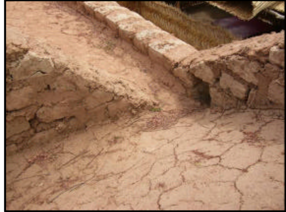
Figure 18 : Samandéni, 2 VN à orientation opposée accolées Evacuation des eaux non optimale : Photo : Wvss 2005
